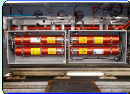
鉄道車両エンジンルーム
