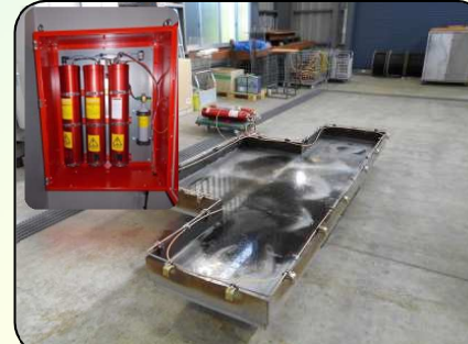
風力発電設備(タワー内)
