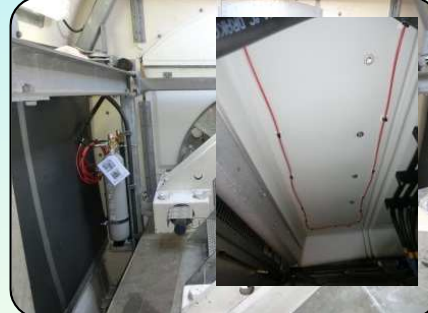
風力発電設備(ナセル内)
