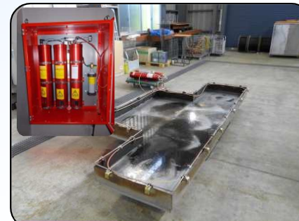
風力発電設備(タワー内)
