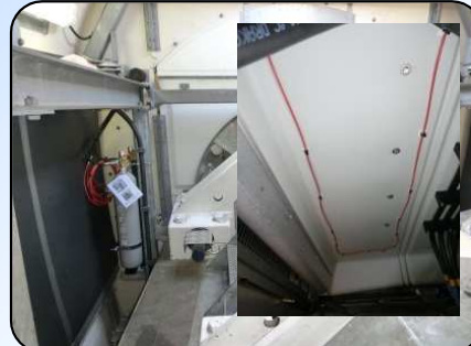
風力発電設備(ナセル内)
